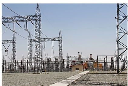
پست ۴۰۰ کیلوولت شوباد کهنوج
