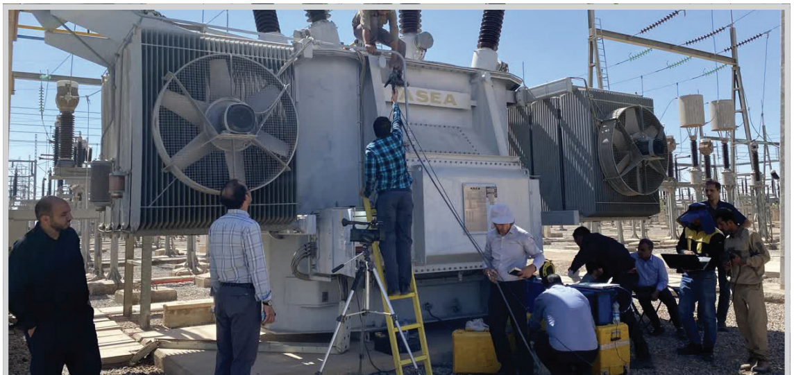
باز آموزشی انجام آزمون صحیح تاژانت دلتای بوشینگ و عمرسنجی بوشینگ‌های ترانسفورماتور با حضور نمایندگان گروه تخصصی تجهیزات پست شرکت توانیر و سازندگان دستگاه تست ترانس ذیل مصوبات کمیته تخصصی توانیر در پست باغین برای همکاران حوزه نظارت برق منطقه‌ای کرمان و شرکت‌های تعمیراتی برگزار گردید
